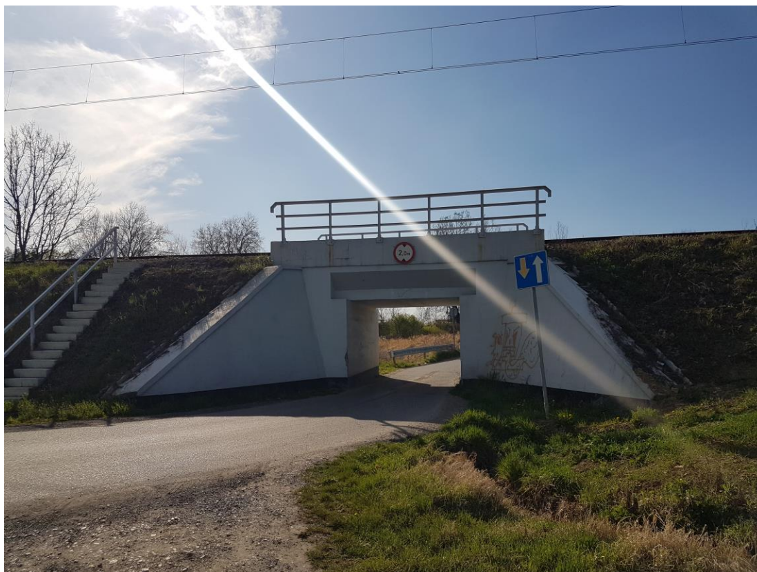
Zdjęcie 7 Ul. Rude-Młyny w miejscu przecięcia z linią kolejową Tamów-Leluchów, przebiegającą na wiadukcie – miejsce przedostania się wód powodziowych na obszar opracowania (Źródło: zdjęcie własne autora)
